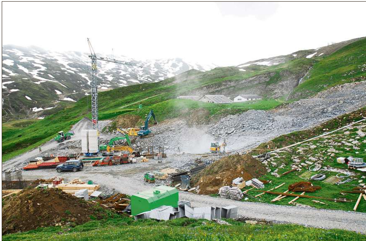
Menar in uffeci da baghegiar ei ina lavur pretendimentsa. Leger plans ei la pli pintga premissa (la foto muossa in plazzal da baghegiar sin territori da Laax).
